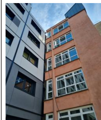
Un projet de rénovation énergétique met deux à quatre ans à aboutir. Archives photo Le DL/I.B.
